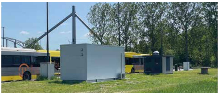
Qbuzz doet, in samenwerking met provincie Utrecht, een pilot met een batterijopslagsysteem voor het hergebruik van batterijen in Nieuwegein.
