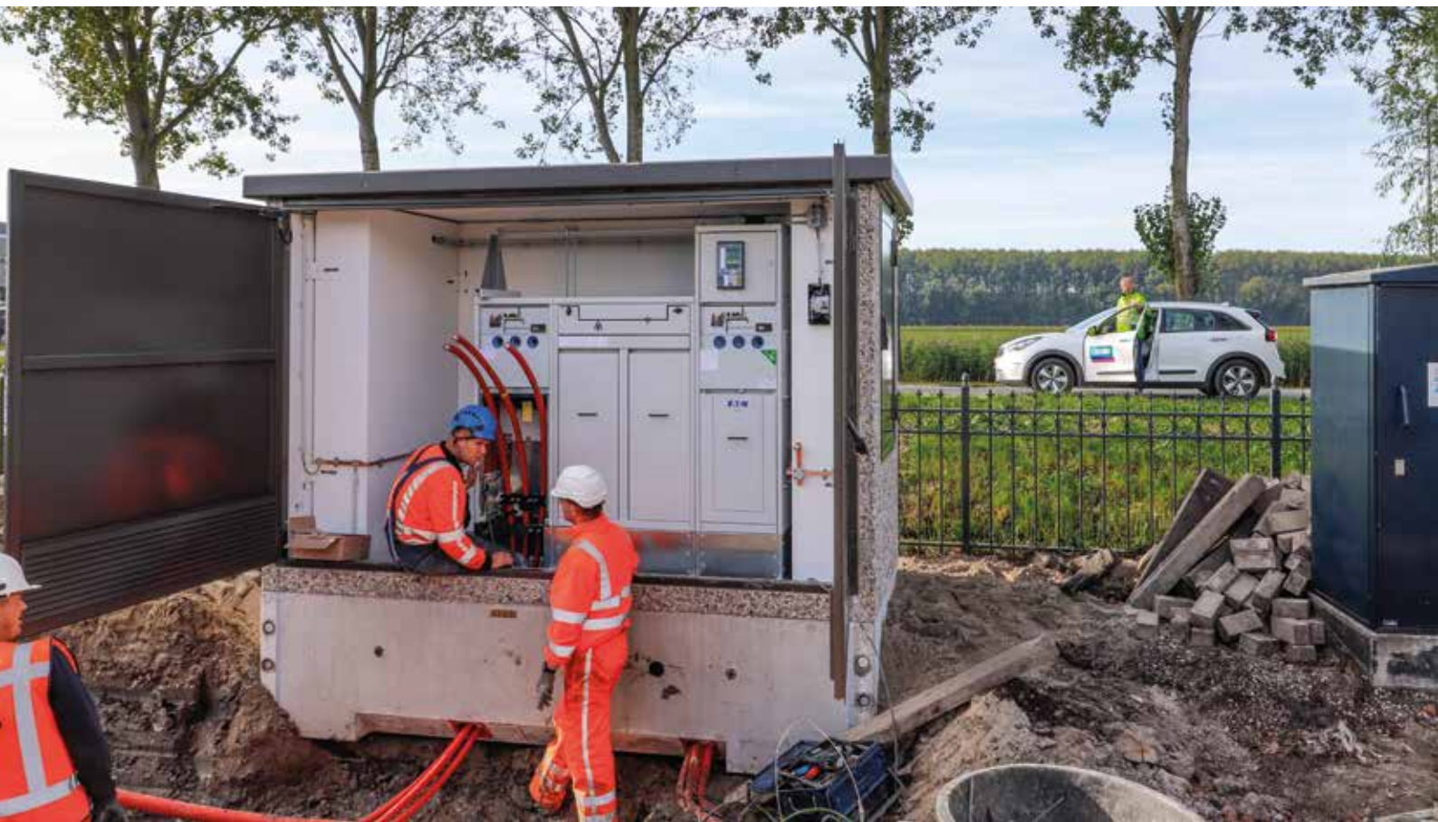
Liander werkt aan een onderstation. Voor de elektrificatie zijn netverzwaringen nodig, maar volgens experts zijn netverzwaringen een desinvestering. © Liander
